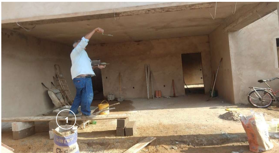
Figura 7. Improviseo no trabalho em altura no canteiro de obras 4
