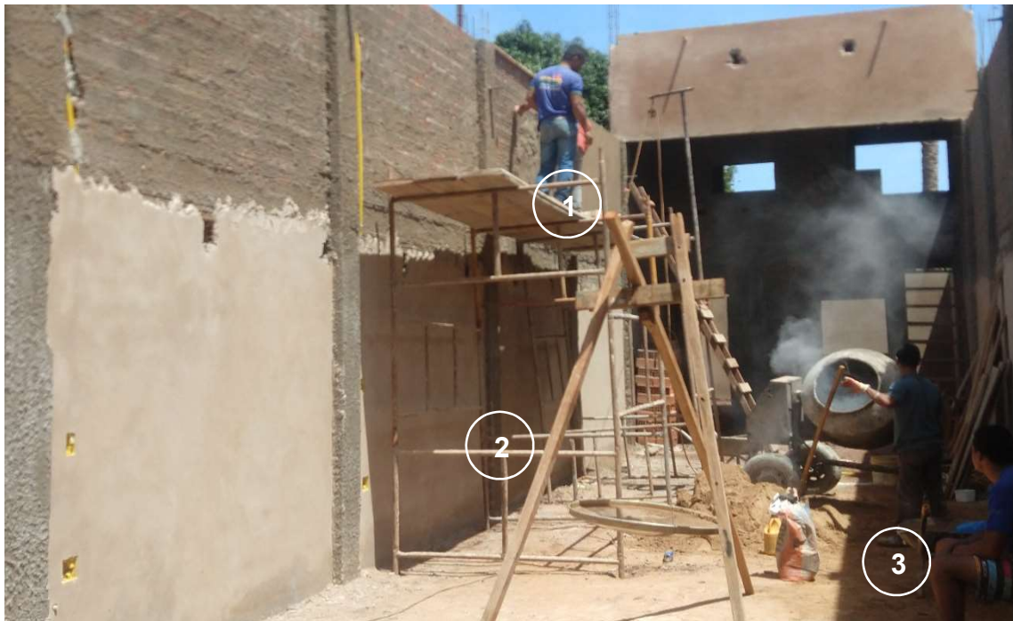
Figura 11. Execução de serviço em altura sem uso de EPI's
