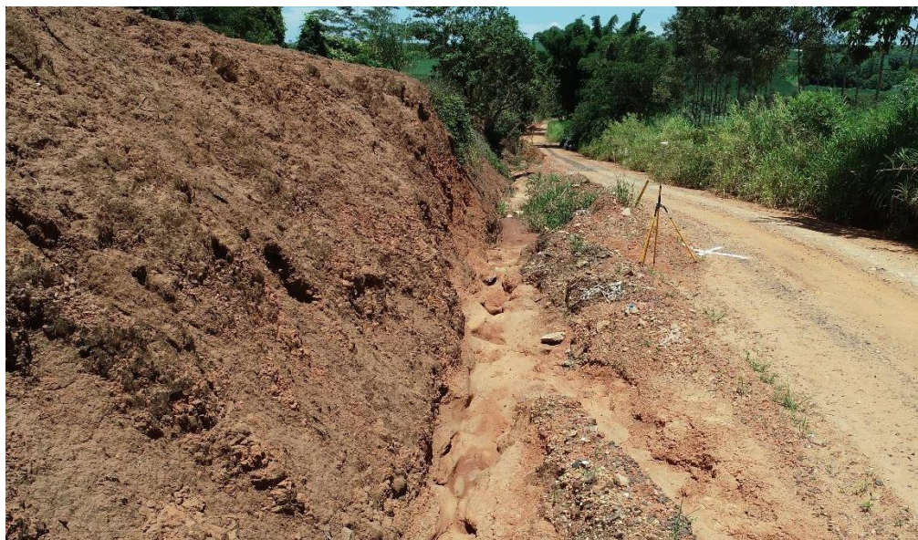
Figura 2 - Erosão na estrada e talude adjacente
