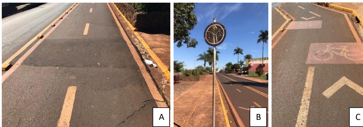
FIGURA 6 – Presença de trincas e remendos em alguns trechos do pavimento (A), e sinalização vertical (B) e horizontal (C) que apresentam desgaste
