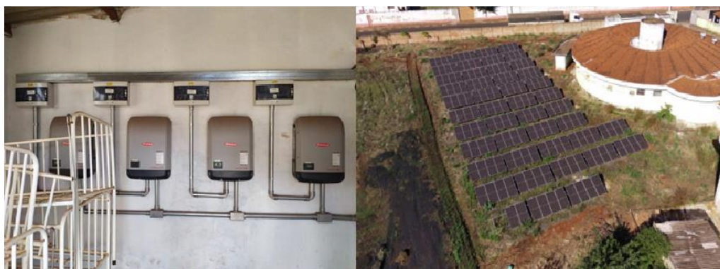
Figura 3 – Gerador fotovoltaico do Hospital São Vicente de Paula de Viradouro-SP
