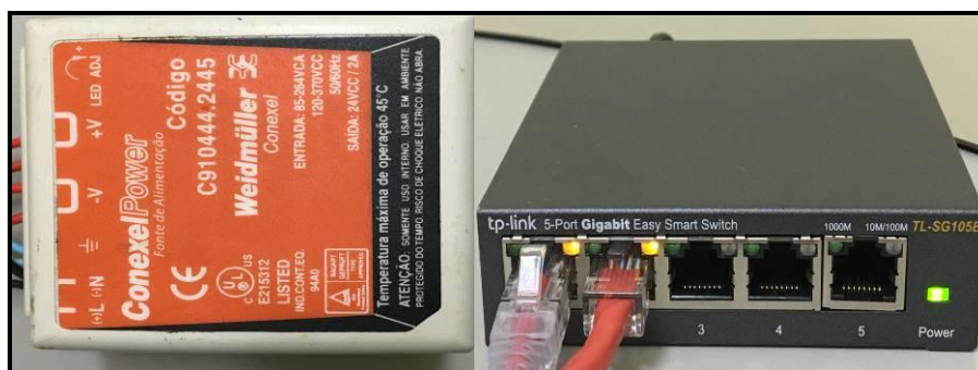
Figura 4. Fonte de Energia e Switch.
